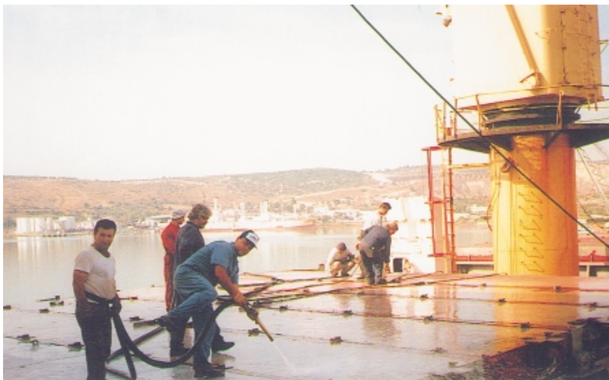
Εικόνα 13.9: Το πλήρωμα εκτοξεύει νερό με πίεση μεταξύ των τμημάτων των καλυμμάτων απλής έλξης, για διαπίστωση της στεγανότητάς του
